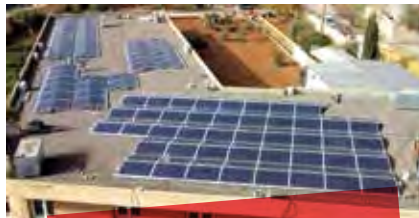
Jetzt repariert und wieder funktionsfähig: die Photovoltaik-Anlage der Geburtsklinik
