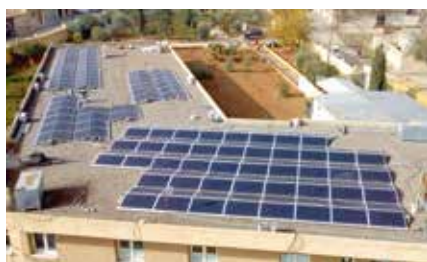
Solar-Anlage auf dem Geburtzentrum Kobanê: Angesichts der Angriffe und Zerstörung der Infrastruktur von Rojava durch das türkische Militär gibt es auch bei anderen Hilfsorganisationen Überlegungen für die Errichtung von mehr Solaranlagen in Rojava
